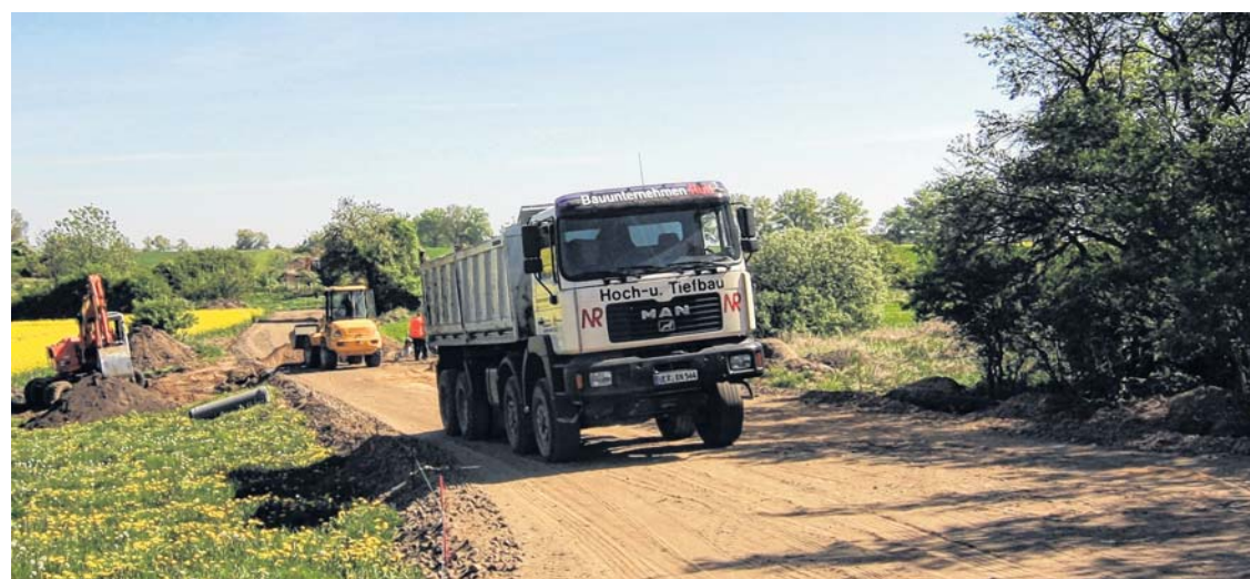
Die Arbeiten an der über rund 60 Jahre voll gesperrten Straße zwischen Ladenthin und Warnik schreiten voran. Auf deutscher Seite beginnt schon in Kürze die Asphaltierung der Straße.
